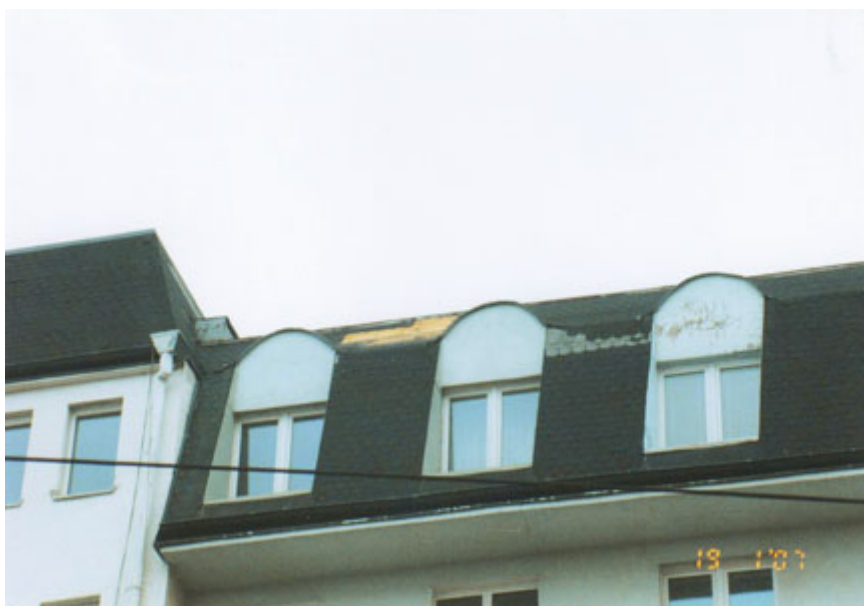
Zerwany gont bitumiczny wraz z podłożem z papy – budynek we Wrocławiu
