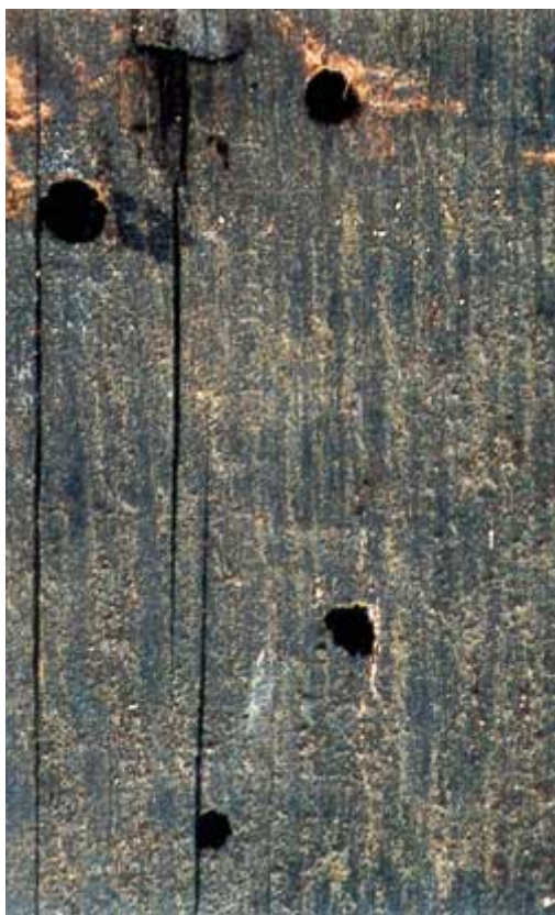
Fot. 4. Otwory wylotowe chrząszczy zmorsznika na powierzchni drewna podwaliny - barak obozowy w Muzeum Państwowym Oświęcim - Brzezinka (fot. A.Krajewski)
