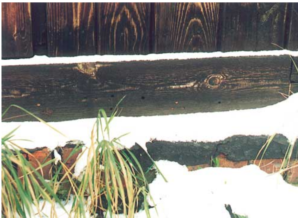
Fot. 6. Nieprawidłowe posadowienie podwaliny baraku obozowego - widoczny jest topniejący śnieg, zbierający się na poziomej izolacji z papy na koronie podmurówki, powodujący zawilgocenie drewna (fot. A.Krajewski)
