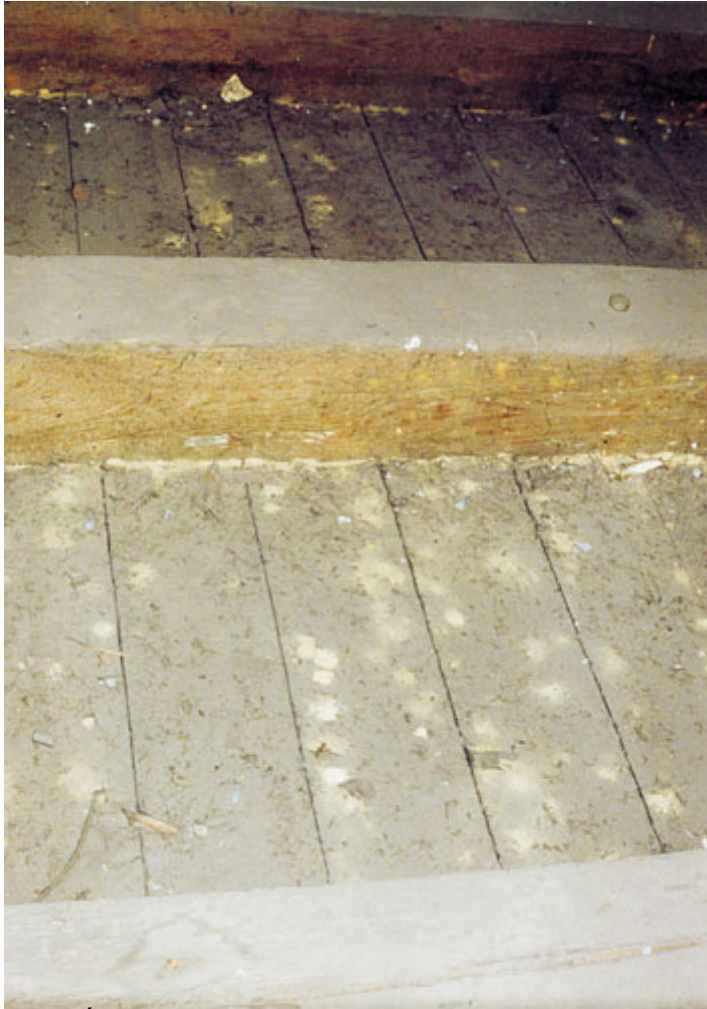
fot.2. Świeże otwory wylotowe w belkach stropu i kopczyki tzw. mączki drzewnej na deskach stropu (widok od str. poddasza)
