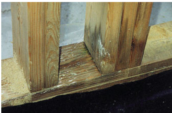
fot. 4. Rozwój pleśni na zawilgoconych nie zabezpieczonych chemicznie elementach podwaliny w budynku szkieletowym.
