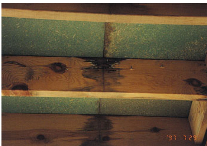
fot. 5. Rozwój pleśni na zawilgoconym stropie w budynku szkieletowym.
