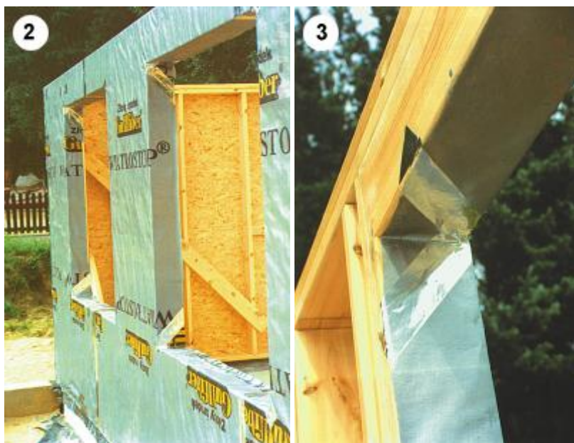
Zdjęcie 2. Otwory okienne, Zdjęcie 3. Szczegóły osłony narożnika otworu okiennego.
