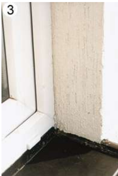
Fot.3. Typowe uszkodzenia EIFS
