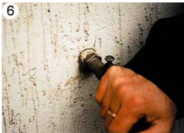
Fot.6. Nieszczelności wokół kranu
