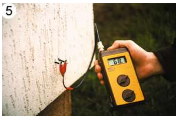
Fot.5. Wynik pomiaru poniżej kranu na elewacji tylnej
