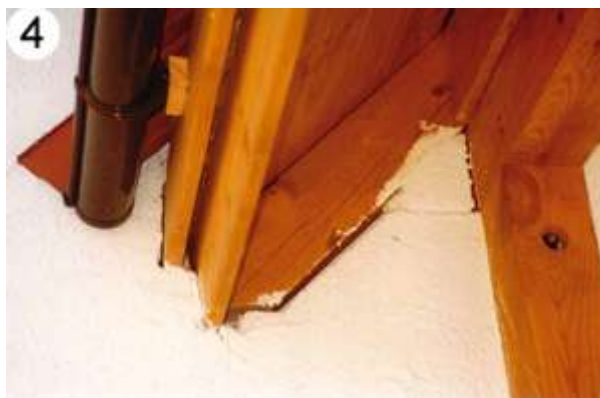
Fot.3. Typowe uszkodzenia EIFS
