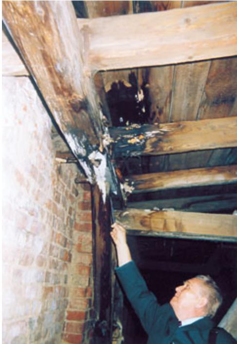
fot. 5. Elementy drewnianej konstrukcji porażone przez białe grzyby domowe ( Fibroporia raillanta ) oraz przez grzyby pleśniowe i bakterie.
