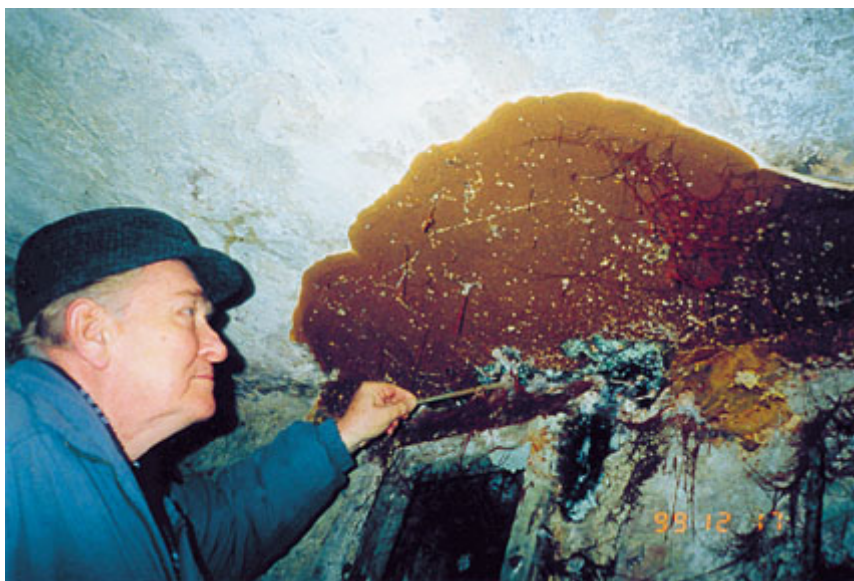
fot. 6. Na ścianie i suficie - grzyb domowy właściwy ( Serpula lacrymans ) z olbrzymim owocnikiem.
