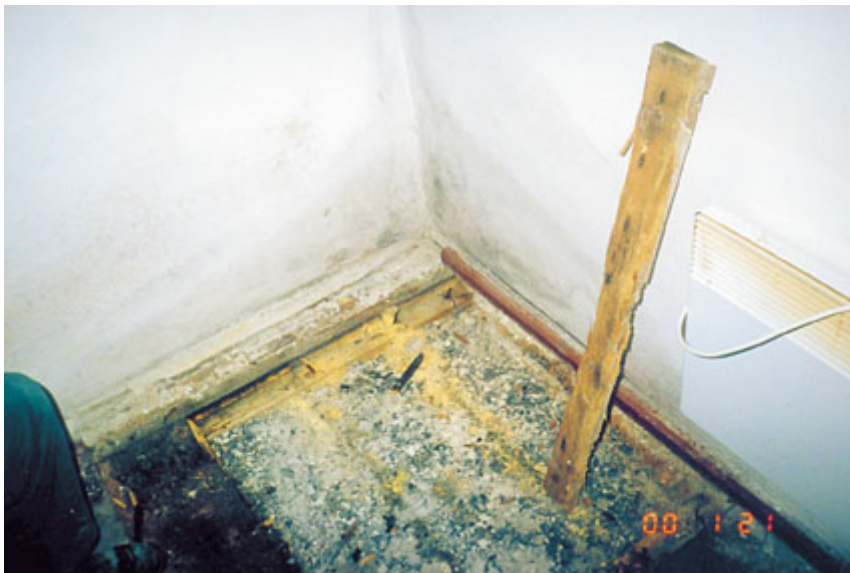
fot. 2. Podłogi zniszczone przez grzyby domowe i grzyby pleśniowe.
