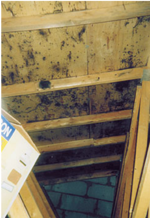
fot. 4. Drewno porażone przez grzyby i bakterie.
