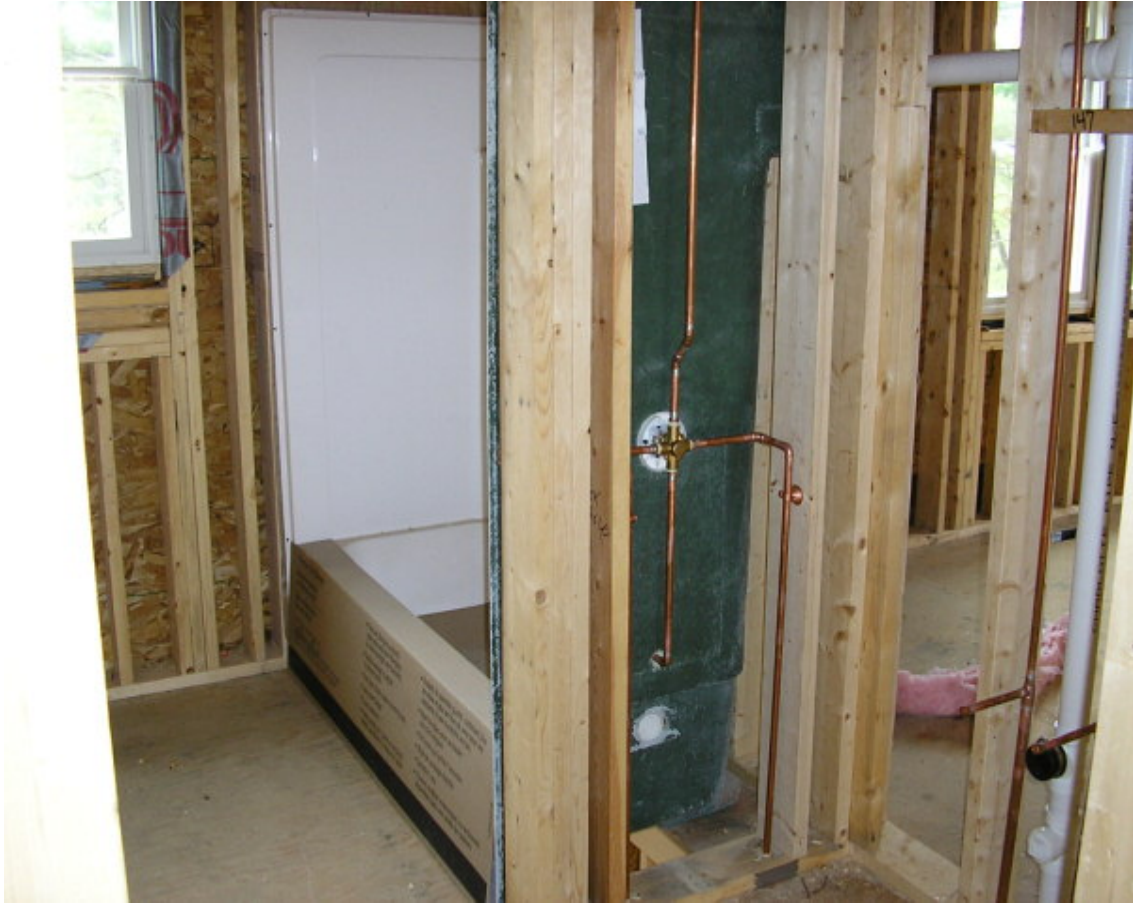
Instalacja wodna kabiny
